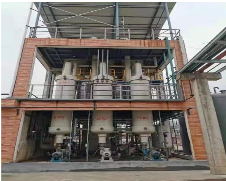
废水脱盐预处理设施
