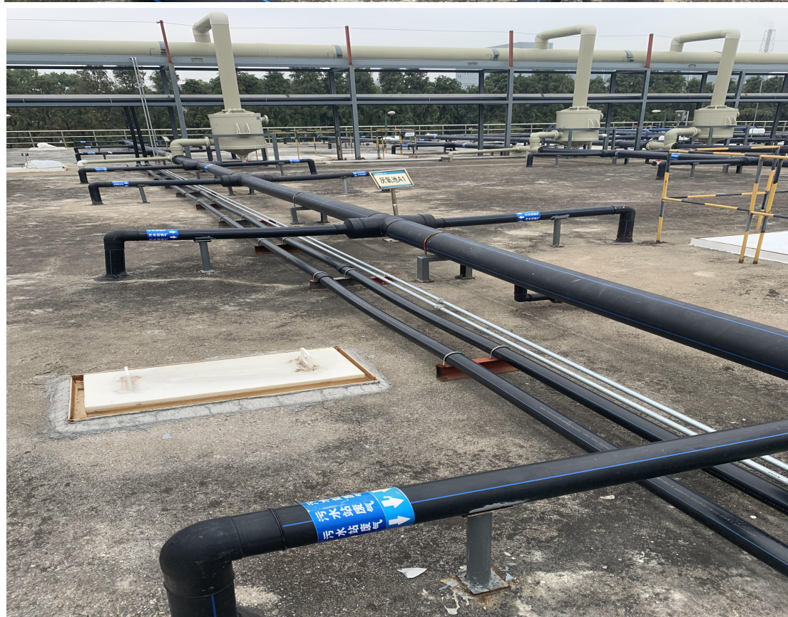
废水站废气收集
